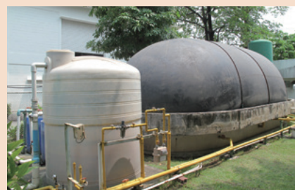
バイオガス貯蔵タンク
