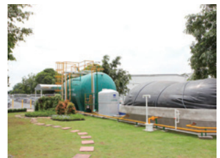
バイオガス発生設備
