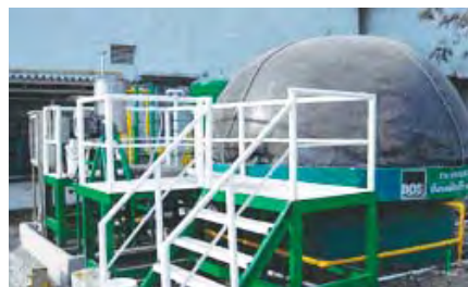
タイ・ロッブリ工場に設置されたバイオガス発生プラント
