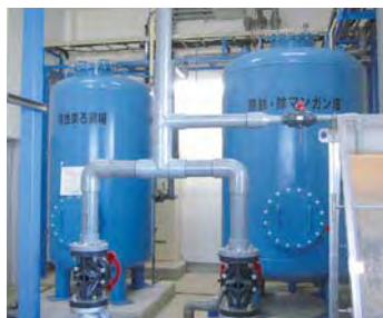
湧水を有効利用するためのろ過装置
