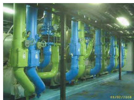
タイのバンバイン工場に導入した高効率タイプの冷凍機
