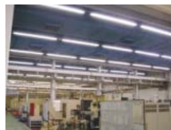
照明器具交換後の工具工場
