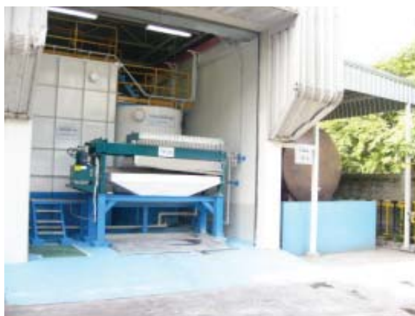
ロジャナ工場に新規に設置した排水処理装置
