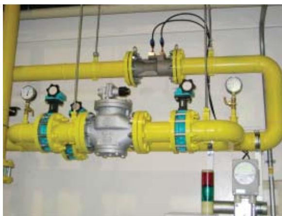
圧縮空気の流量計と減圧弁
