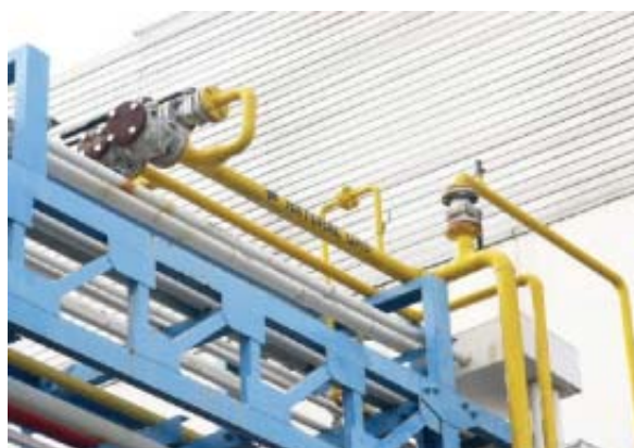
天然ガスの供給ライン
