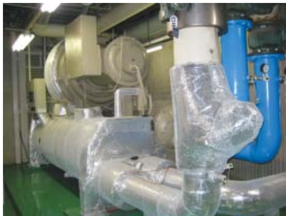
新たに導入した高効率タイプ冷凍機
