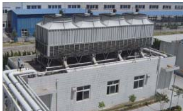
上海順鼎科技有限公司の冷却塔
