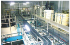
藤沢工場の排水処理設備
