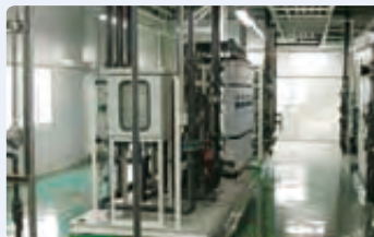
中国・上海工場の排水処理施設（2009年1月稼働開始）
