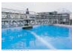
タイ工場の排水処理施設
