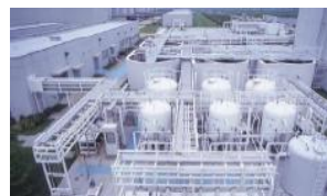
上海工場排水処理センター
