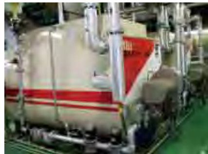
軽井沢工場の都市ガスボイラー
