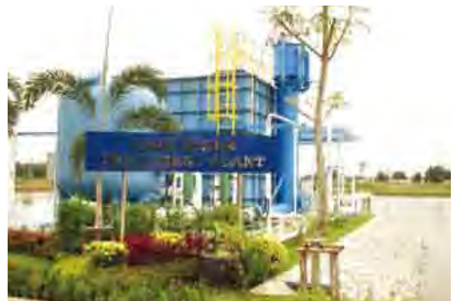
タイ/バンパイン工場の雨水再利用装置と貯水池
