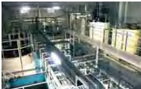
藤沢工場の排水処理設備
